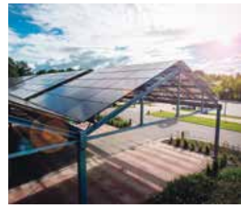
Zonnepanelen parkeerterrein Swimfun
