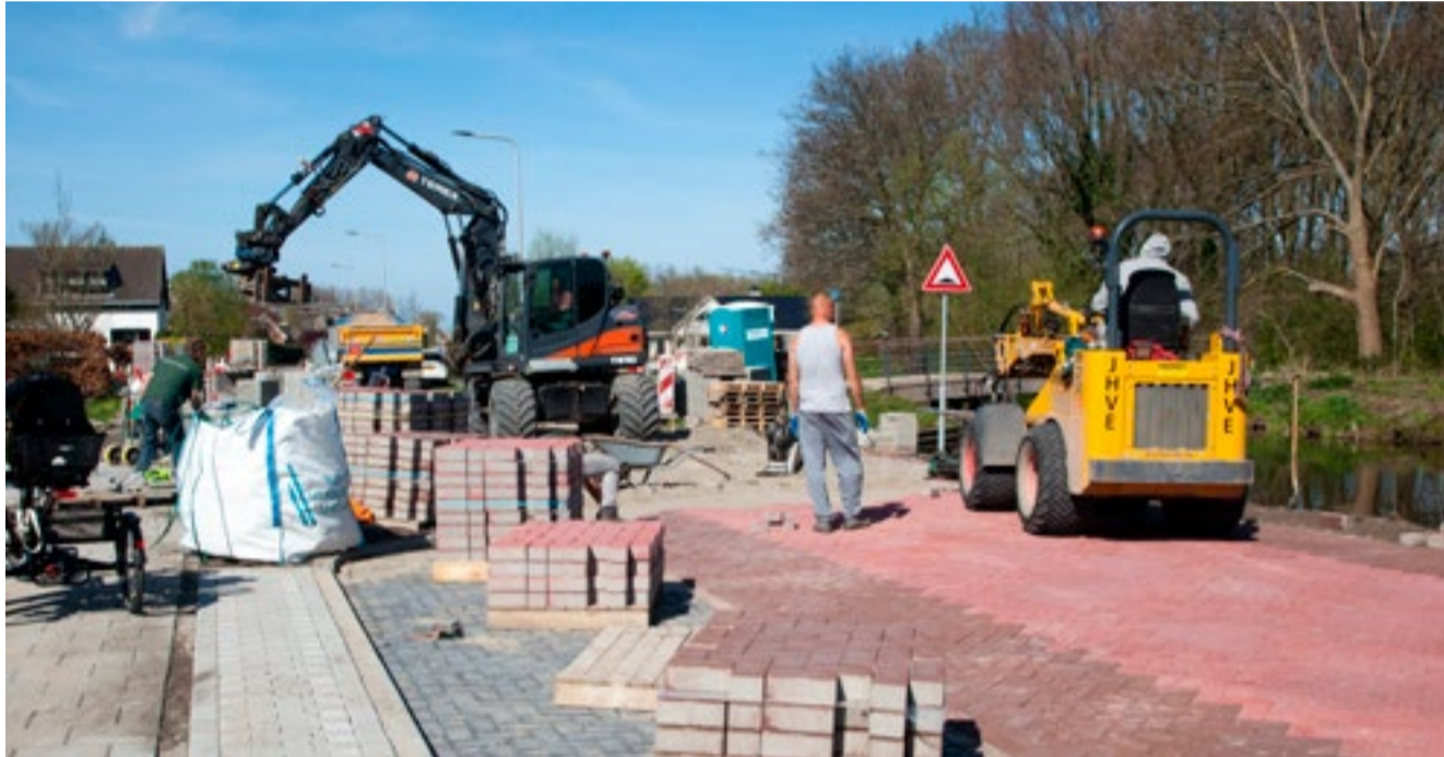
De laatste meters van het nieuwe wegdek van het Treebord en de Oudeweg worden aangelegd.
