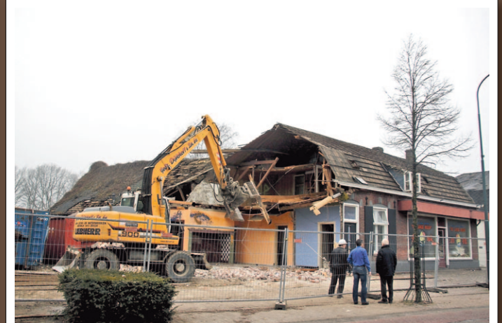
De burens zijn getuige bij de eerste sloopwerkzaamheden van het Chinees Restaurant.
