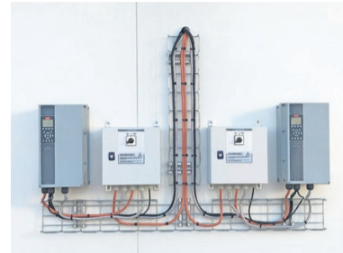
Frequentieregelaars ten behoeve van ventilatoren
