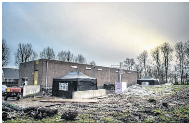
■ De situatie op dit moment bij het distributiepompstation.
