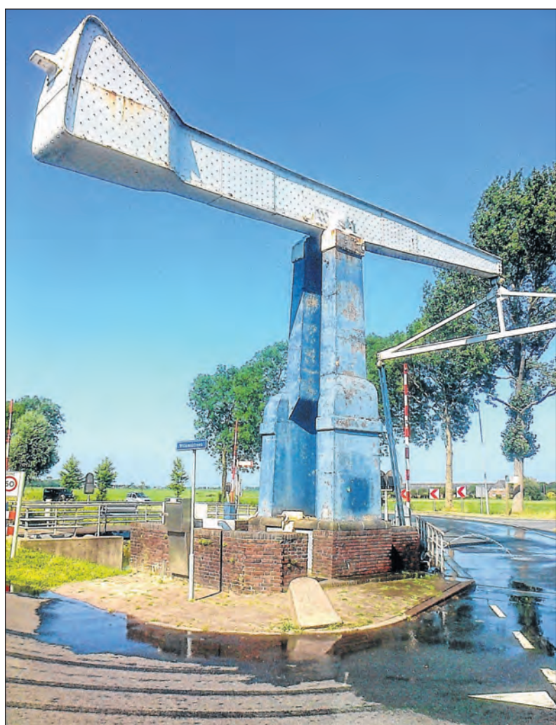
■ De in slechte staat verkerende brug bij Ellerhuizen moest het het afgelopen weekend wederom ontgelden (foto: APB Bedum).
