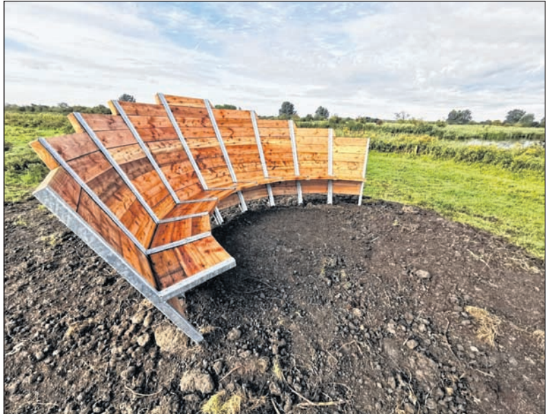
■ De curvebank die in Zoutkamp geplaatst is.
