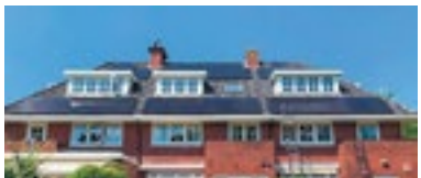
Installatie van zonnepanelen op drie woningen in de Jan Steenlaan in Naarden. De bewoners hebben een gezamenlijk legplan gemaakt.
