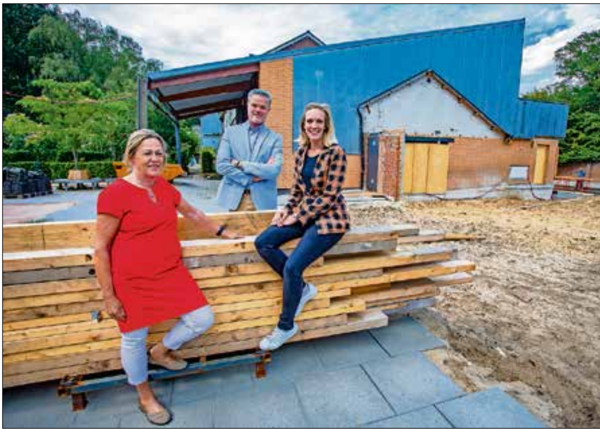
■ Birgitta Abeling, Bart van de Vlist en Rianne Zeeman bij de deels gesloopte school.
