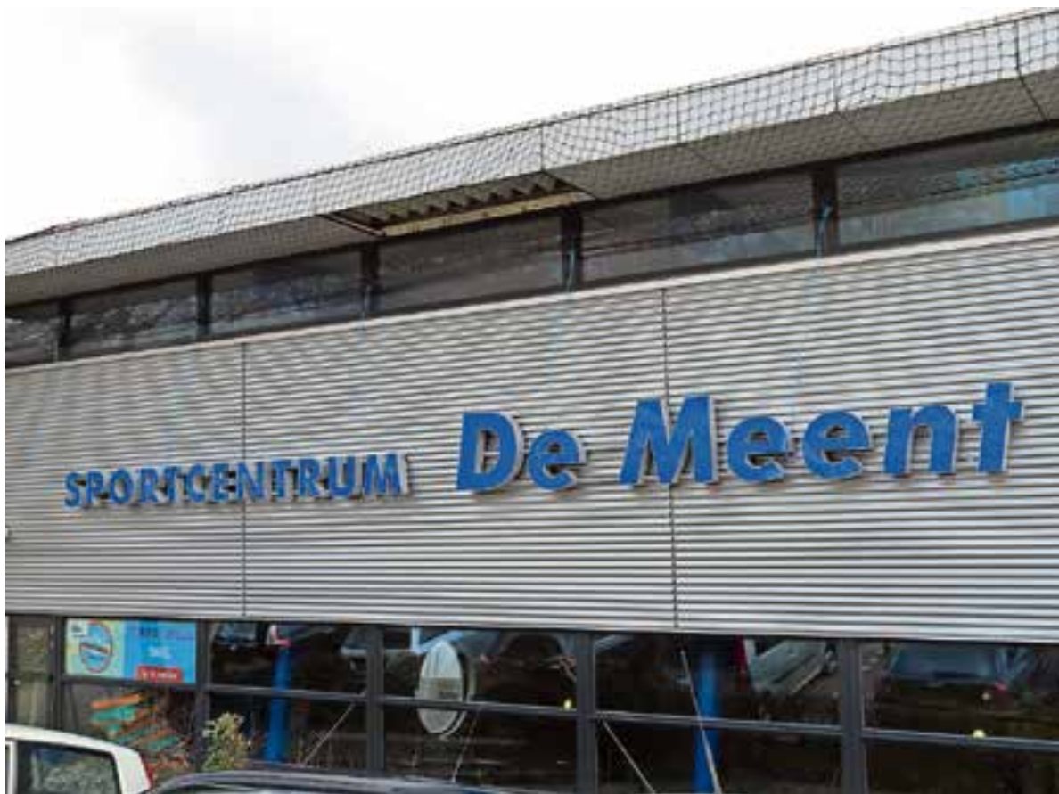
■ Uit voorzorg zijn de loshangende geveldelen weggehaald en is een net gespannen. FOTO: CARIN VAN DEN BERG
